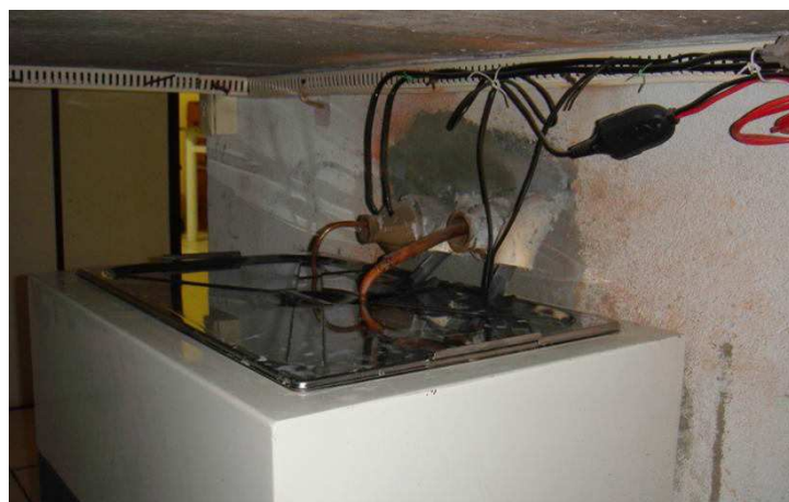
Figura 1 - Tanque de refrigeração.
