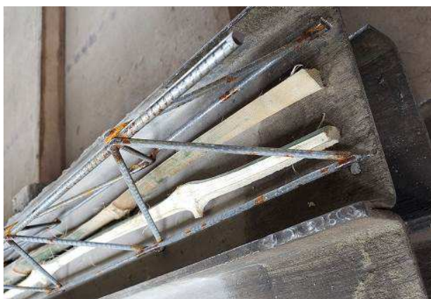
Figura 1 – Composição do bambu com a treliça metálica na fôrma antes da concretagem
